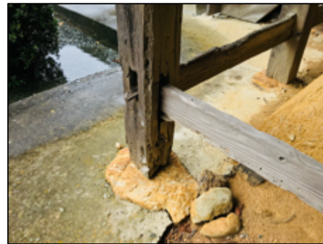
図12 實相寺庚申堂（柱腐朽部）
