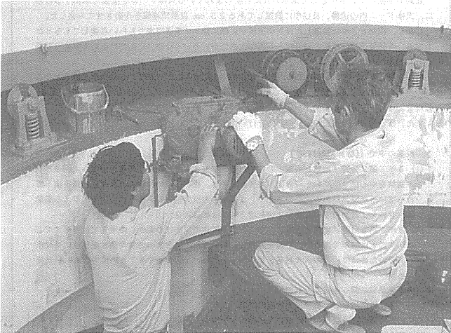
図3. 天体ドームのモーターと回転により接触する部分を修理している。
