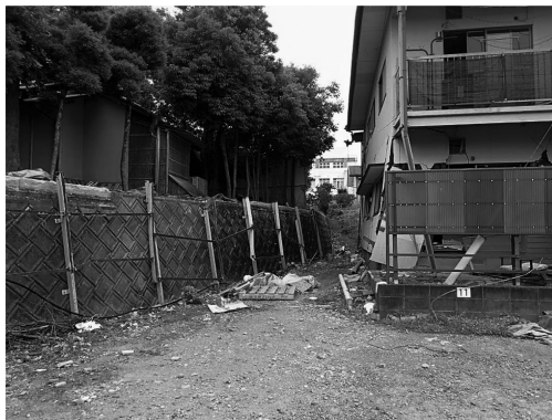
写真6 左手石垣上にあった高さ約2mのブロック塀が倒壊し、写真中央付近で犠牲者が発生と推定される。
