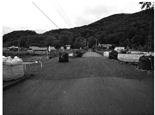
写真7 新得町西二条北三丁目付近。手前の砂利敷き部分が流失したが復旧し埋め戻されている。2016年9月18日撮影。
