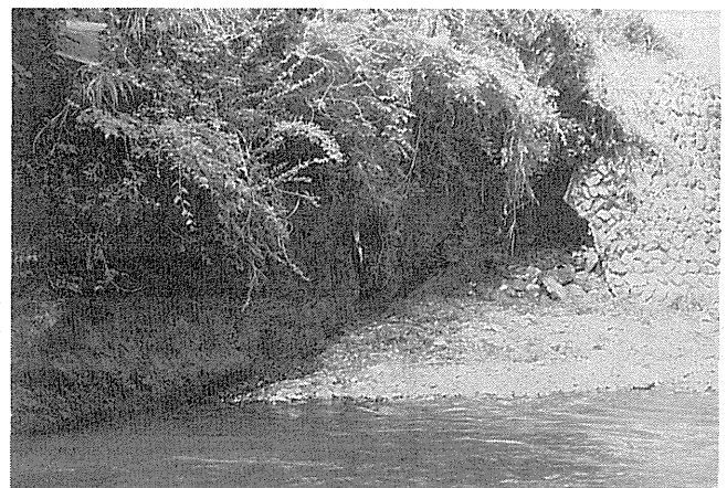
写真5 三段池橋にみられる断層
