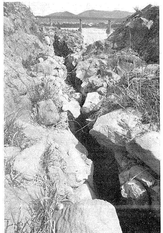
下流方向の断裂
