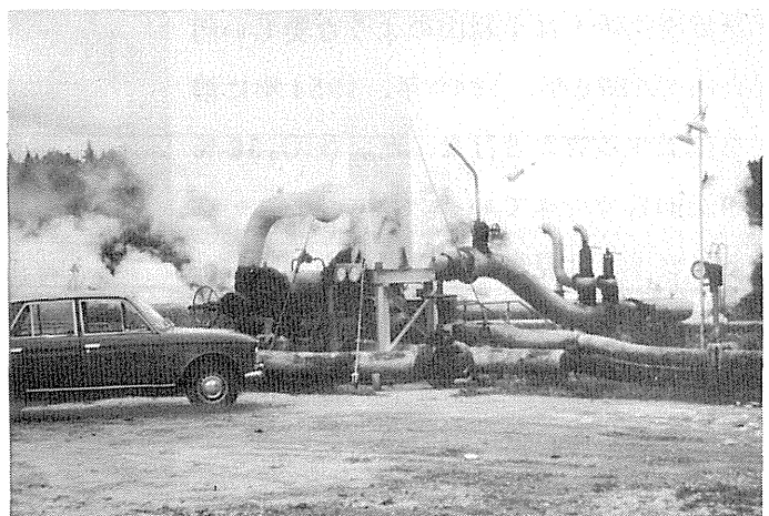
蒸気井に設けられた気水分離塔
