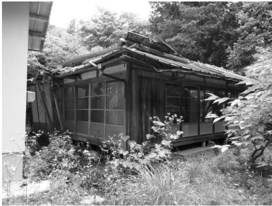
写真2 長年空き家となって倒壊する 無居住寺院R寺の庫裏(くり)
