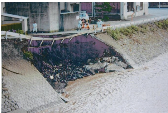
図4. 平成22年(2010年)9月の台風9号により決壊した小山町横の護岸(保坂, 2011, 2019を転載)。
