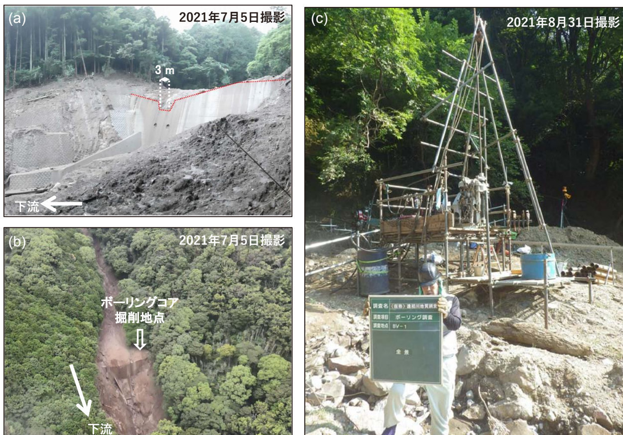
図2 土砂災害発生後の砂防堰堤。(a) 下流から見た砂防堰堤。(b) 砂防堰堤の空中写真とボーリングコア掘削地点。静岡県(2021e)から引用。(c) ボーリングコア掘削の現場写真。静岡県から提供。
