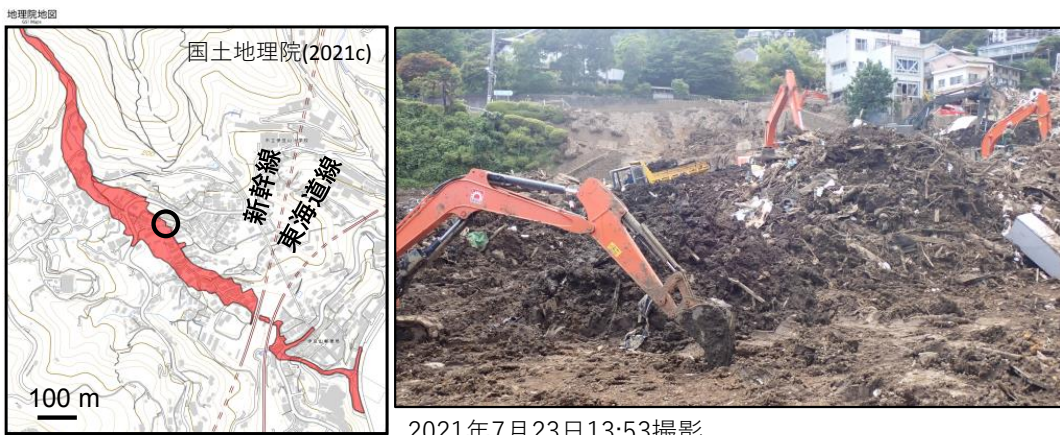
図21 地点A2の被災家屋2の直ぐ下流地域の状況。撮影地点の位置は北緯35度6分49.89秒，東経139度4分53.32秒。
