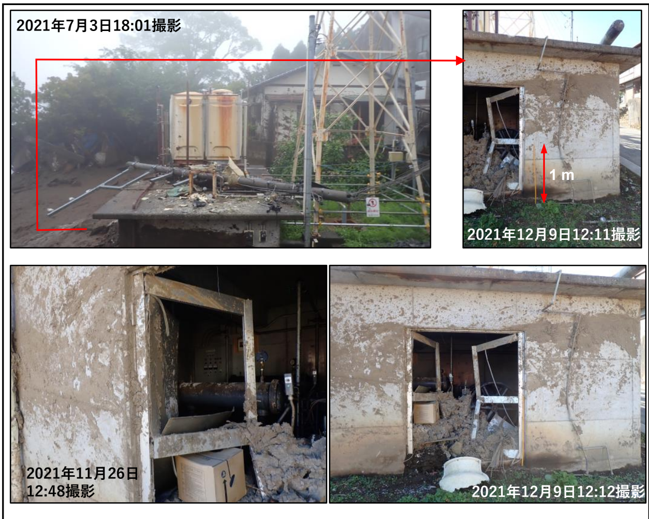
図12 地点A2にある源泉施設.
