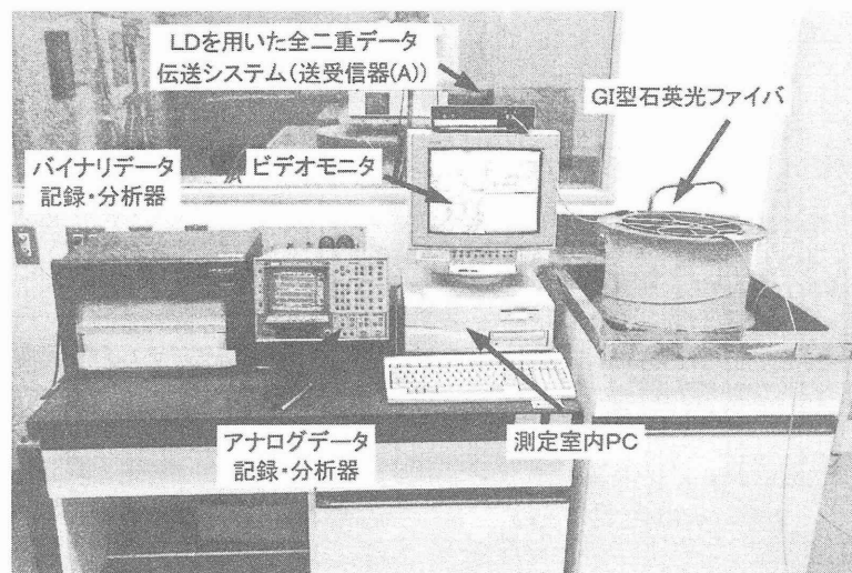
図4.3 測定室内に設置されたデータ収集・伝送システムの構成
