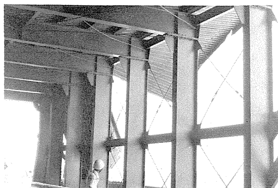
写真6 第五洞門内部構造 焼津側残存部・H型鋼柱の断面は600×200×11×17mm
